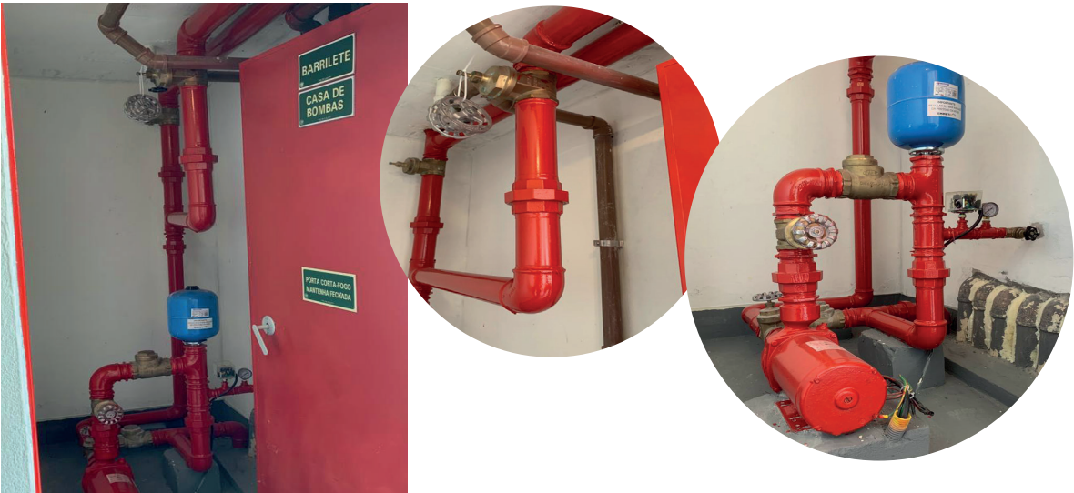
Figura 101 Casa de bombas e detalhe da bomba pressurizadora do sistema hidráulico preventivo e registros do sistema
