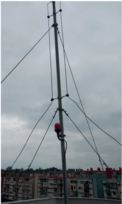
Figura 78 Iluminação de sinalização no captador do SPDA
