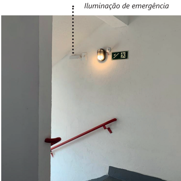
Figura 105 Iluminação de emergência na parede da escada
