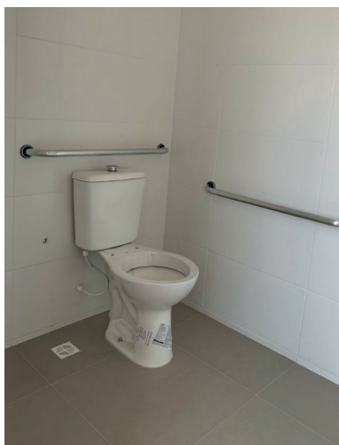
Figura 60 Bacia com caixa acoplada em louça na área de lazer
