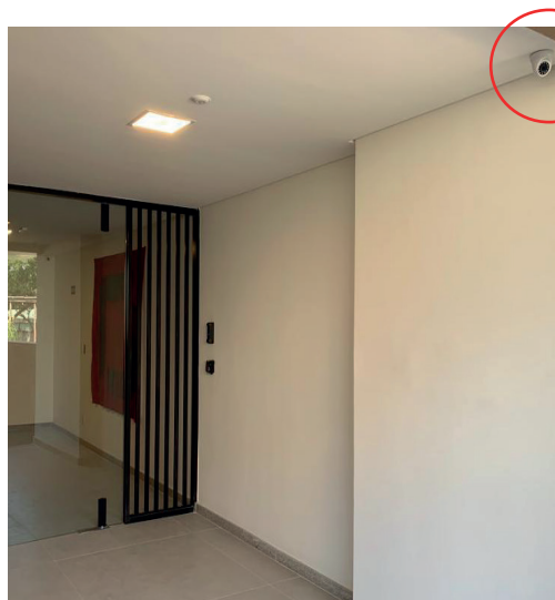
Figura 94 Sistema de CFTV instalado no hall de acesso ao edifício
