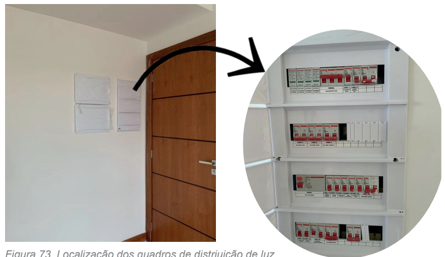
Figura 73 Localização dos quadros de distribuição de luz atrás da porta social do apartamento
