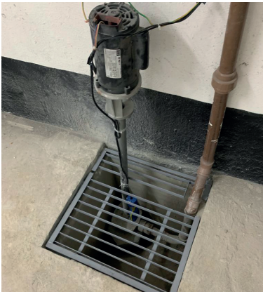
Figura 54 Bomba do sistema de água pluvial
