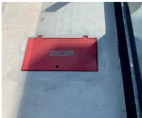
Figura 102 Hidrante de recalque na calçada frontal ao edifício
