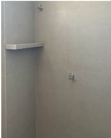
Figura 66 Registro na parede do box do banheiro do apartamento
