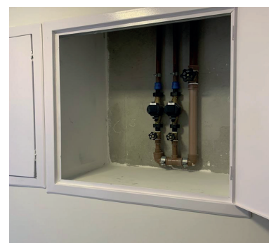
Figura 51 Medidores de água nos armários de shaft no hall do pavimento tipo
