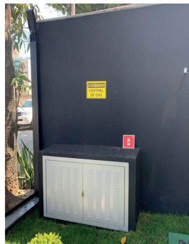
Figura 84 Localização da válvula de entrada e registro de gás natural do edifício
