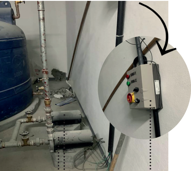
Bombas de recalque
