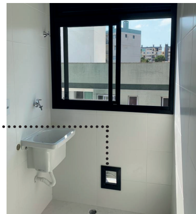
Figura 88 Ventilação permanente a baixo da janela da área de serviço, não obstruir a ventilação
