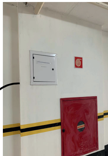
Figura 85 Localização da válvula de bloqueio de gás na garagem
