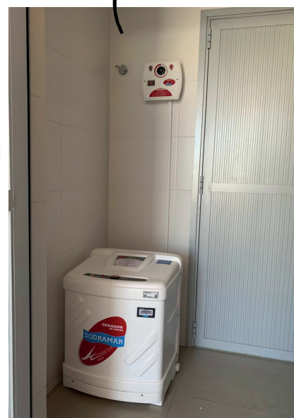
Figura 112 Equipamento de sauna e detalhe do quadro de comando
