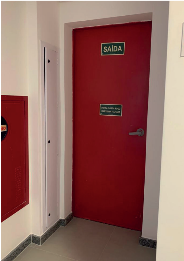
Figura 106 Porta corta fogo
