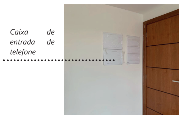
Figura 98 Caixa de entrada no apartamento do cabeamento de antena
