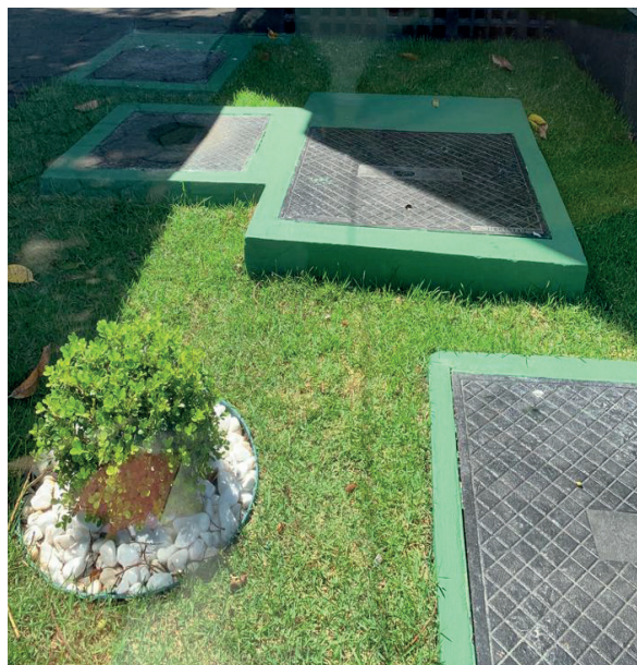
Figura 57 Caixa de gordura e inspeção no afastamento frontal do edifício
