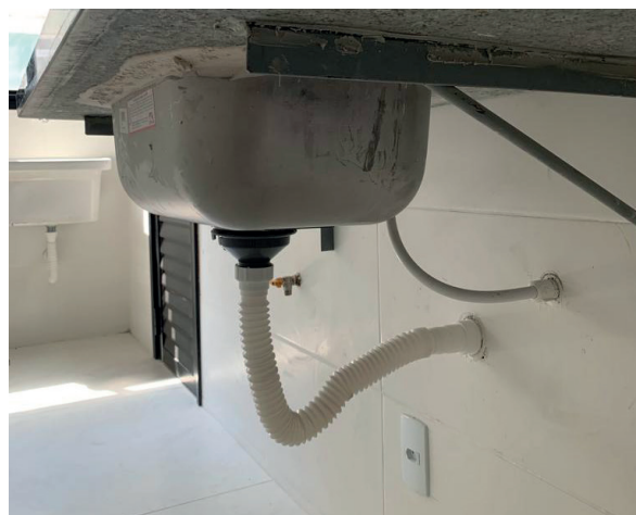
Figura 71 Sifão da pia da cozinha no apartamento
