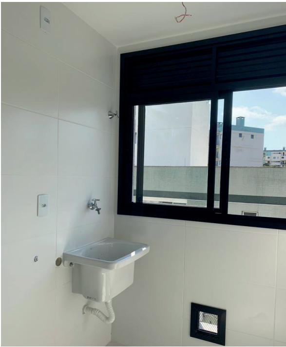
Figura 43 Janela da área de serviço do apartamento de alumínio com vidro
