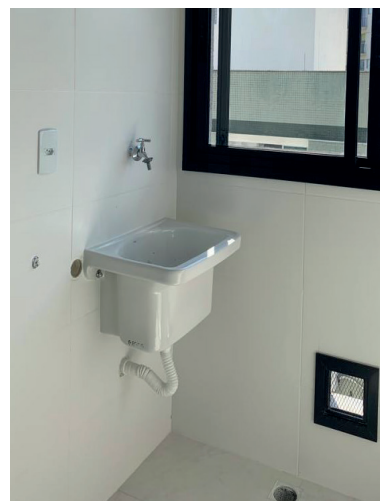
Figura 62 Tanque em louça na área de serviço do apartamento
