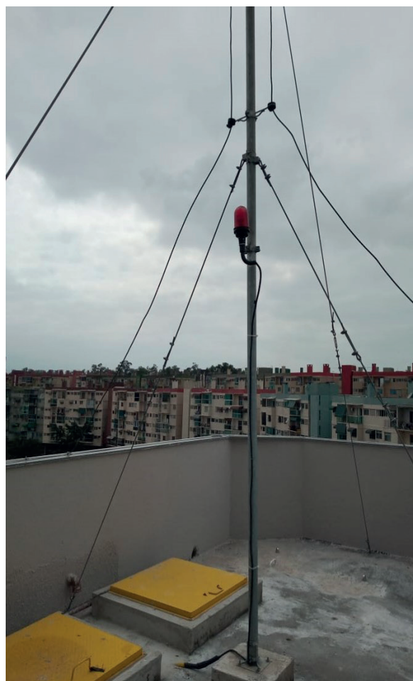
Figura 90 Captador do sistema de SPDA
