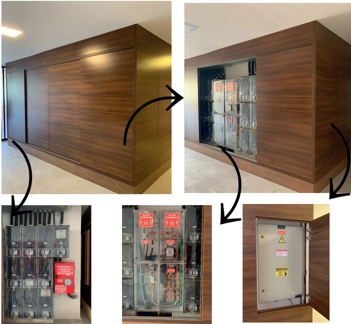
Figura 72 Armário com os medidores individuais de elétrica, o barramento geral e as chaves gerais, no hall do pavimento térreo.
