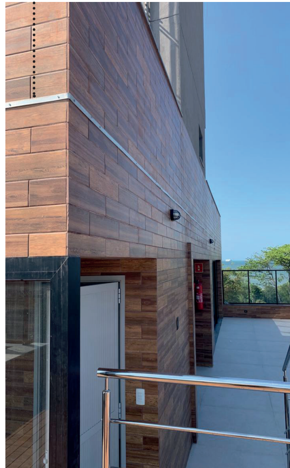
Figura 89 Barra chata que faz parte do sistema de SPDA
