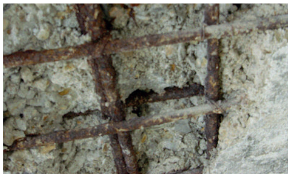
Figura 1 Exemplo de Corrosão por carbonatação
